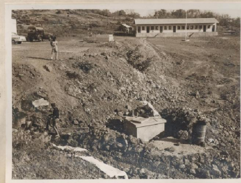
Na câmara de manobras dos reservatórios (fotografia 2) colocou-se o venturi; na caseta, distante cerca de vinte metros, foram colocados o mostrador e o registador. Não há interesse em separar as peças. Não parece condigna a caseta do contador, o qual, aliás, não funciona. O aspecto geral é de obras inacabadas.
